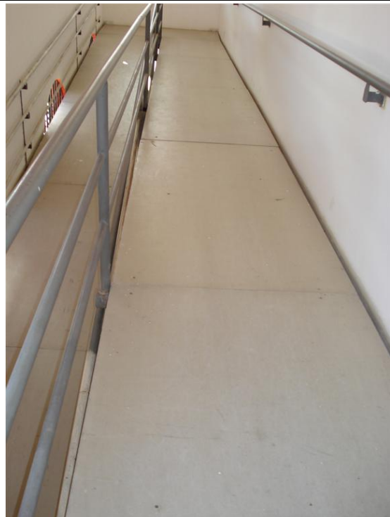
Foto – Rampa de acesso aos Laboratórios do piso superior, montada em madeirite sobre estrutura metálica, sem revestimento antiderrapante. Maceió, 26 de maio de 2015.
