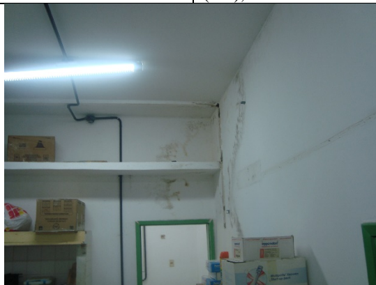
Foto – Térreo, sala de guarda de materiais do LABMAR com infiltrações, Maceió (AL), 22 de maio de 2018.
