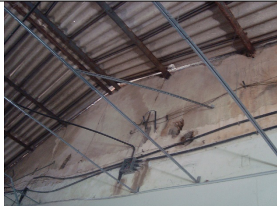
Foto – Parte superior, ferragens de sustentação da cobertura da sala de exposição com sinais de ferrugem, Maceió (AL), 22 de maio de 2018.
