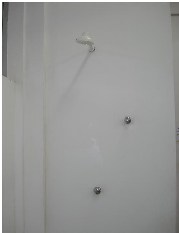
Foto – Chuveiro de emergência do Laboratório Didático nº 1 do IQB/UFAL. Crivo de menos de 30 cm, sem acionamento por alavanca, sem lava-olhos e sem plataforma. Maceió, 26 de maio de 2015.
