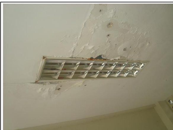
Foto - Forro de gesso do “hall” de acesso ao pavimento superior danificado devido à água que se infiltrou pela laje e que também motivou o aparecimento de pontos de ferrugem na luminária. Maceió (AL), 21 de maio de 2018.
