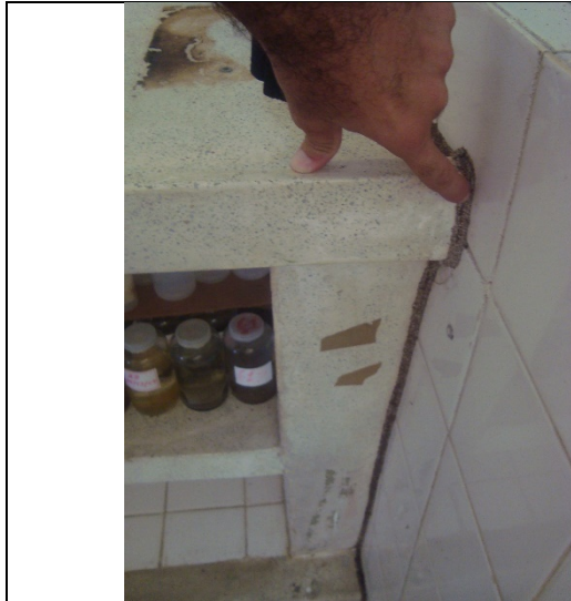
Foto – Térreo, laboratório do LABMAR com sinais de cupim, Maceió (AL), 22 de maio de 2018.
