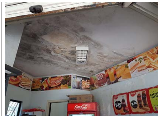
Foto – Cantina da FEAC – Infiltrações e vazamentos no teto. Maceió, AL, em 10 de março de 2018.
