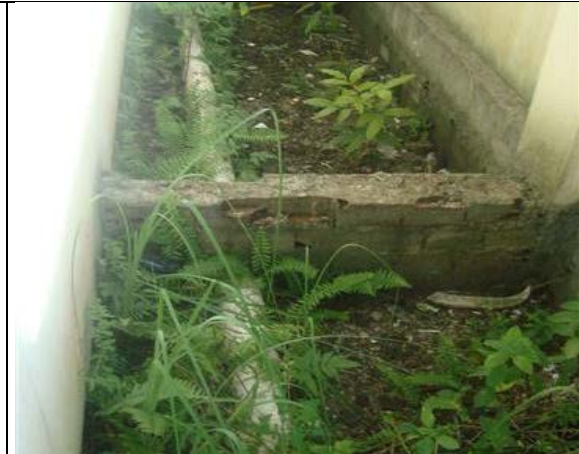
Foto – Jardineira interna, não impermeabilizada, apresentando infiltrações. Maceió (AL), 21 de maio de 2018.
