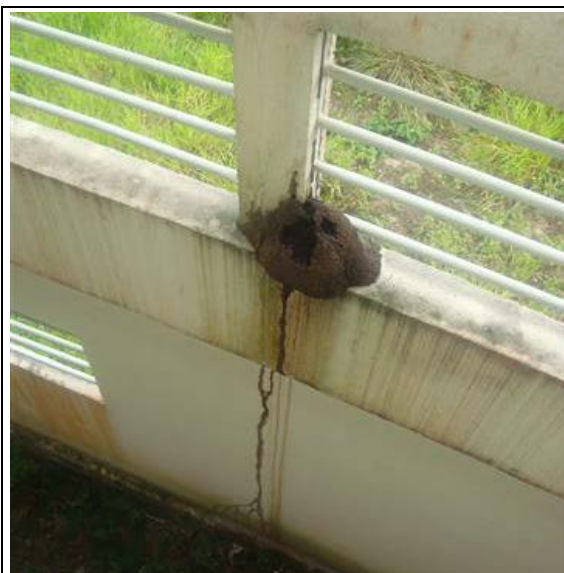
Foto – Ninho de cupins na parte interna da fachada posterior. Maceió (AL), 21 de maio de 2018.
