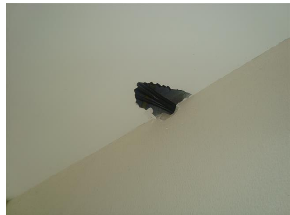
Foto – Ponto, no hall de acesso do segundo andar, onde o forro encontra-se com trecho destruído. Maceió (AL), 21 de maio de 2018.
