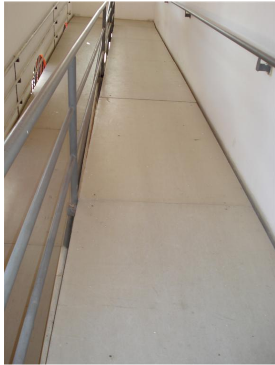
Foto – Rampa de acesso aos Laboratórios do piso superior, montada em madeirite sobre estrutura metálica, sem revestimento antiderrapante. Maceió, 26 de maio de 2015.
