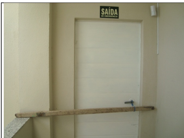
Foto – Vista da porta corta fogo, mostrando que a mesma encontra-se travada de forma improvisada, com caibro de madeira. Maceió (AL), 10 de junho de
