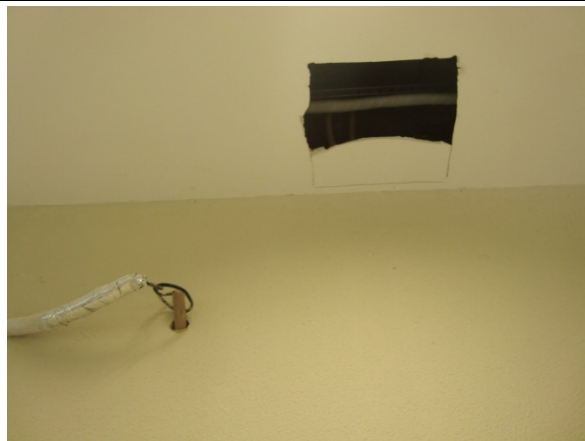
Foto – Vista de ponto onde o referido forro encontra-se com trecho destruído. Maceió (AL), 10 de junho de 2015.
