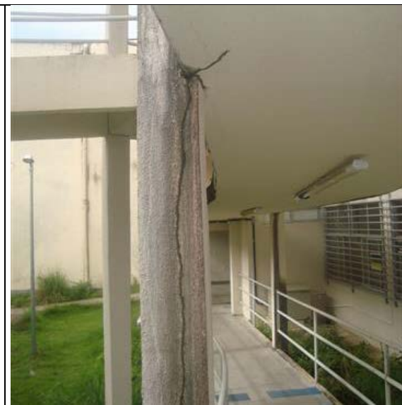
Foto – Trilha de cupim em um dos pilares da rampa de acesso, onde também se observa a ausência de calhas de escoamento na rampa. Maceió (AL), 21 de maio de 2018.
