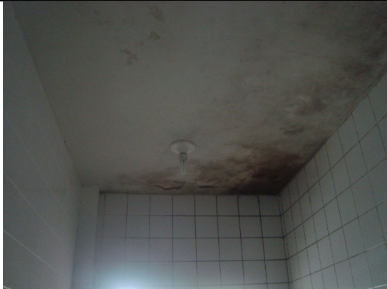
Foto – Térreo, banheiro feminino do laboratório de DNA forense com infiltrações no teto, Maceió (AL), 22 de maio de 2018.
