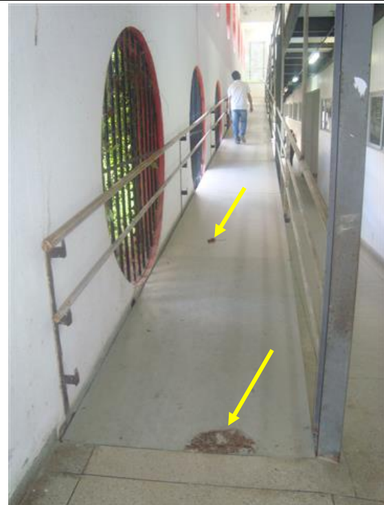
Foto – Rampa de acesso aos Laboratórios do piso superior permanece sem revestimento antiderrapante e já apresenta pontos de desgaste. Maceió, 21 de maio de 2018.
