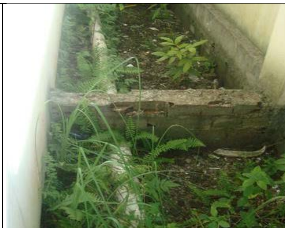
Foto – Jardineira interna, não impermeabilizada, apresentando infiltrações. Maceió (AL), 21 de maio de 2018.
