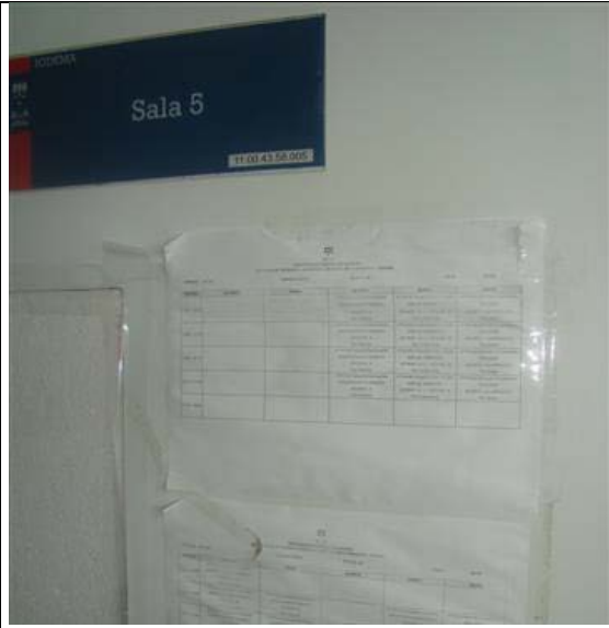
Foto – Porta da sala de aula nº 5, onde se observa a bandeira fechada com isopor, em virtude da ausência do vidro. Maceió (AL), 21 de maio de 2018.
