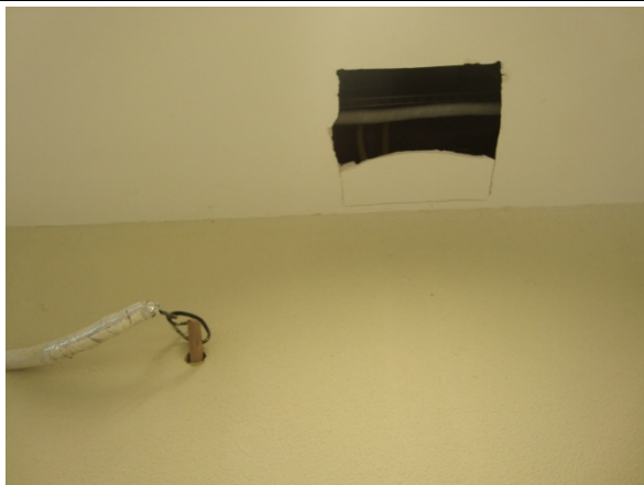
Foto – Vista de ponto onde o referido forro encontra-se com trecho destruído. Maceió (AL), 10 de junho de 2015.
