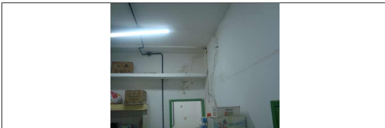
Foto – Térreo, sala de guarda de materiais do LABMAR com infiltrações, Maceió (AL), 22 de maio de 2018.
