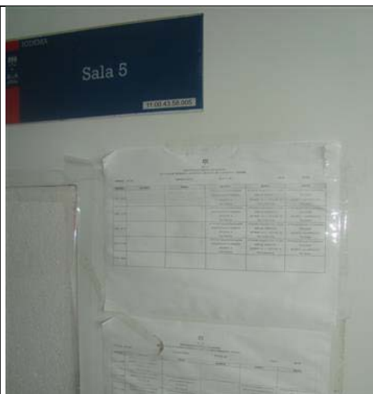
Foto – Porta da sala de aula nº 5, onde se observa a bandeira fechada com isopor, em virtude da ausência do vidro. Maceió (AL), 21 de maio de 2018.
