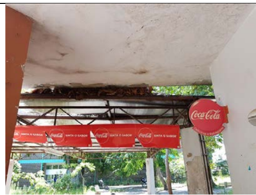
Foto – Cantina da FEAC - estrutura de cobertura metálica sem manutenção e enferrujada. Maceió, AL, em 10 de março de 2018
