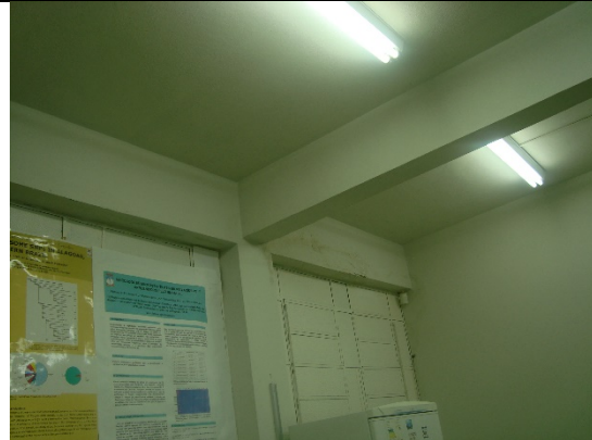
Foto – Térreo, sinais de infiltração na parede do laboratório de DNA forense, Maceió (AL), 22 de maio de 2018.
