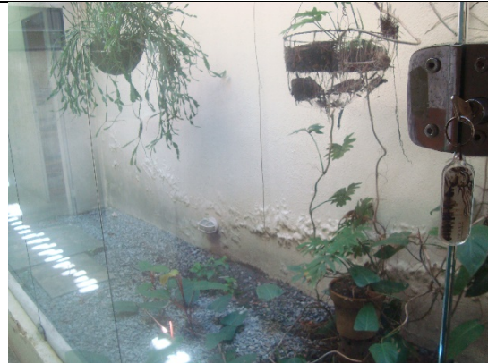
Foto – Térreo, jardim de inverno do laboratório de DNA forense com infiltrações na parede, Maceió (AL), 22 de maio de 2018.
