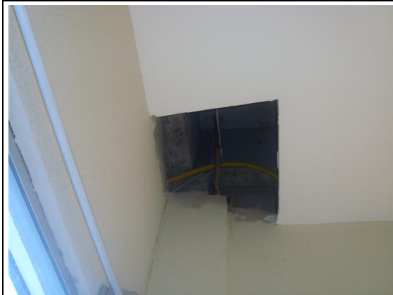
Foto – Laboratório de Educação Geográfica do Estado de Alagoas (LEGAL), onde se nota a abertura no forro, mostrando o duto de eletricidade. Maceió (AL), 21 de maio de 2018.
