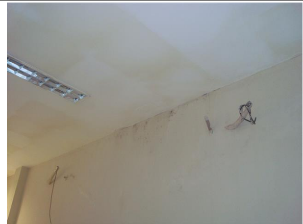
Foto – O Laboratório de Geoquímica Ambiental é uma das salas que apresentam o forro com coloração amarelada, agravada pela infiltração severa. Maceió (AL), 21 de maio de 2018
