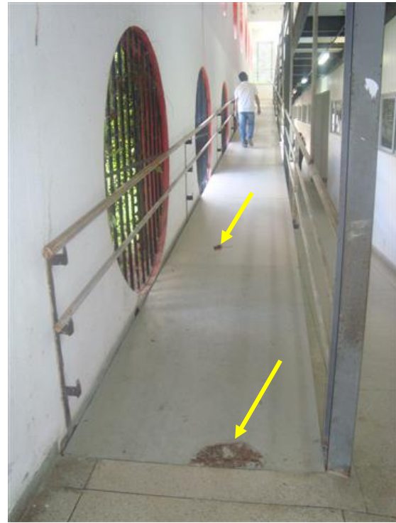
Foto – Rampa de acesso aos Laboratórios do piso superior permanece sem revestimento antiderrapante e já apresenta pontos de desgaste. Maceió, 21 de maio de 2018.
