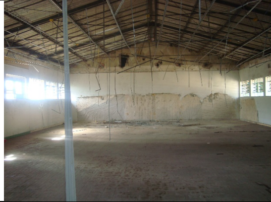
Foto – Parte superior, sala de exposição com ferragens do forro soltas e piso de madeira totalmente danificado, Maceió (AL), 22 de maio de 2018.
