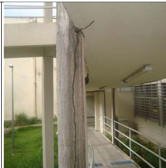
Foto – Trilha de cupim em um dos pilares da rampa de acesso, onde também se observa a ausência de calhas de escoamento na rampa. Maceió (AL), 21 de maio de 2018.
