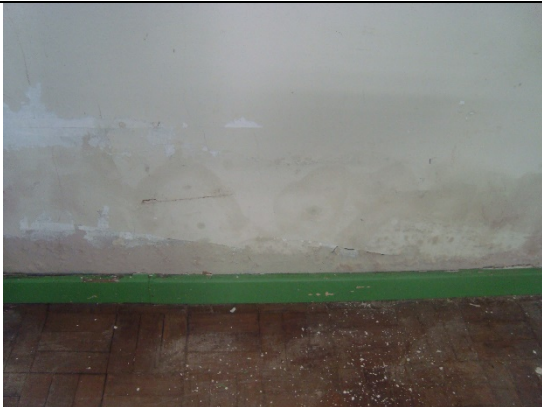
Foto – Parte superior, reboco da sala de exposição com sinais de infiltração, Maceió (AL), 22 de maio de 2018.
