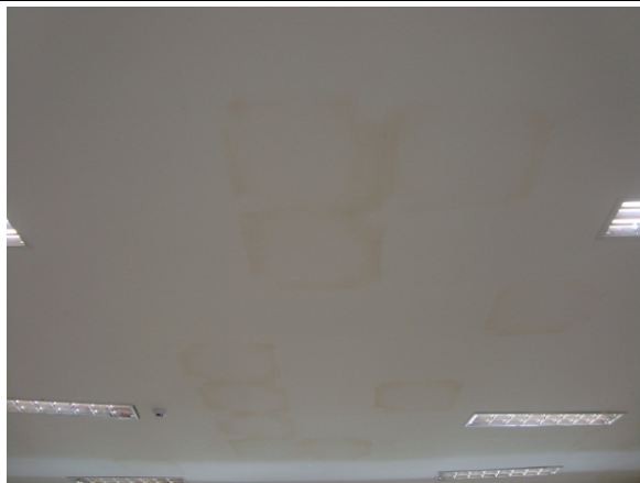
Foto – Vista de ponto onde o forro de gesso já se apresenta com coloração amarelada. Maceió (AL), 10 de junho de 2015.
