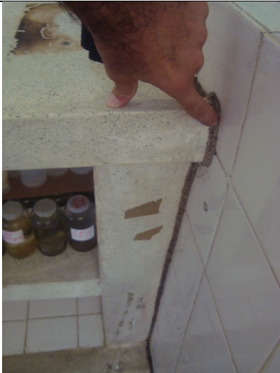
Foto – Térreo, laboratório do LABMAR com sinais de cupim, Maceió (AL), 22 de maio de 2018.
