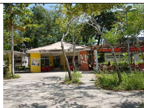
Foto – Cantina da FEAC - estrutura de cobertura sem manutenção. Maceió, AL, em 10 de março de 2018.
