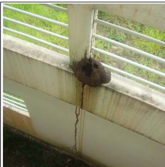
Foto – Ninho de cupins na parte interna da fachada posterior. Maceió (AL), 21 de maio de 2018.
