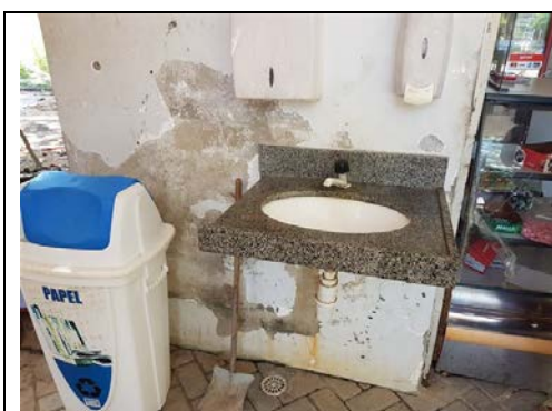
Foto – Cantina da FEAC – vazamentos e falta de manutenção. Maceió, AL, em 10 de março de 2018.
