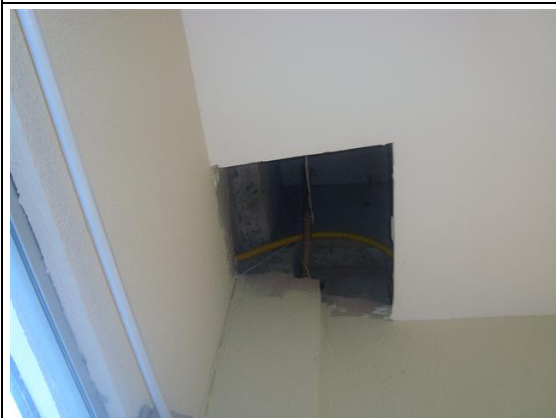
Foto – Laboratório de Educação Geográfica do Estado de Alagoas (LEGAL), onde se nota a abertura no forro, mostrando o duto de eletricidade. Maceió (AL), 21 de maio de 2018.
