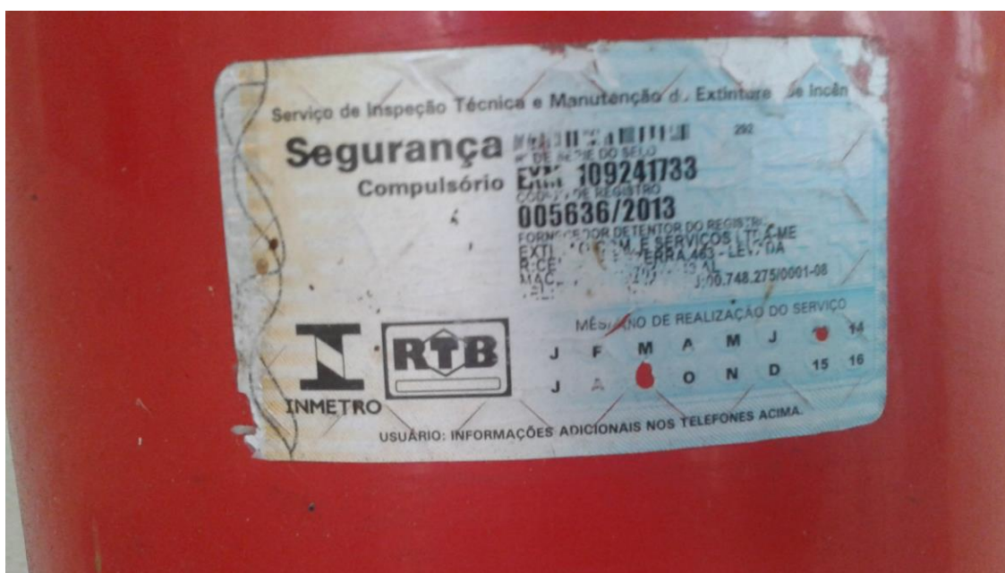
Foto 13: Extintor com selo de segurança de inspeção datado de setembro de 2013.
