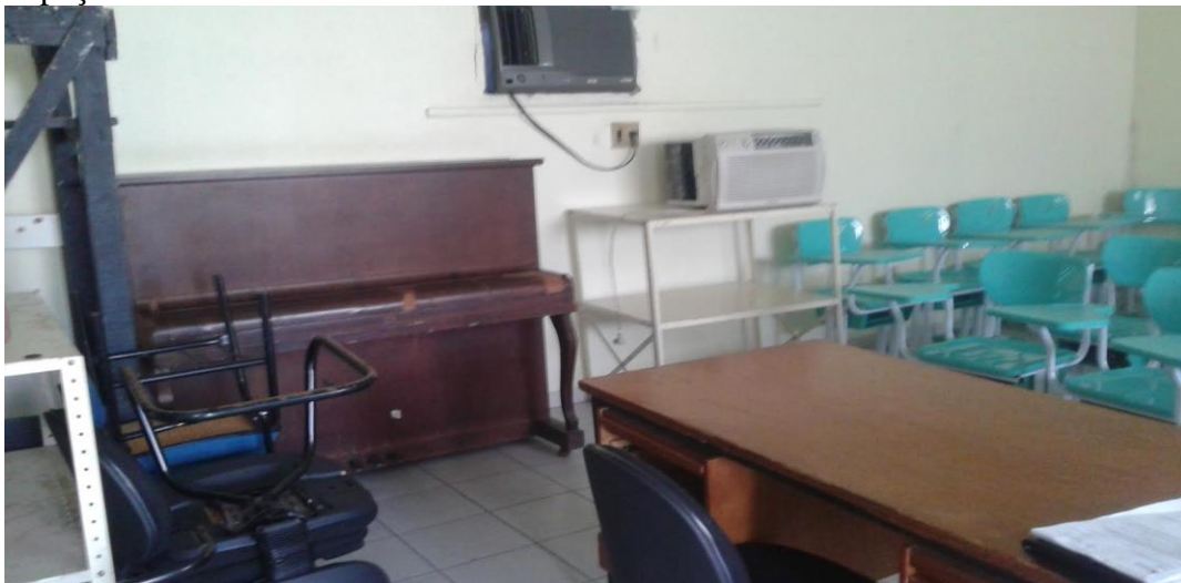
Foto 6: Aparelho de ar-condicionado quebrado ou com defeito em sala de aula do Espaço Cultural.
