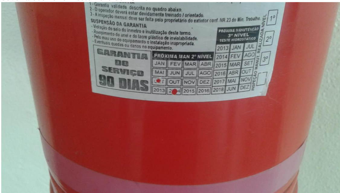
Foto 12: Extintor com manutenção vencida. Dados informam que próxima manutenção deveria ocorrer em setembro de 2014.
