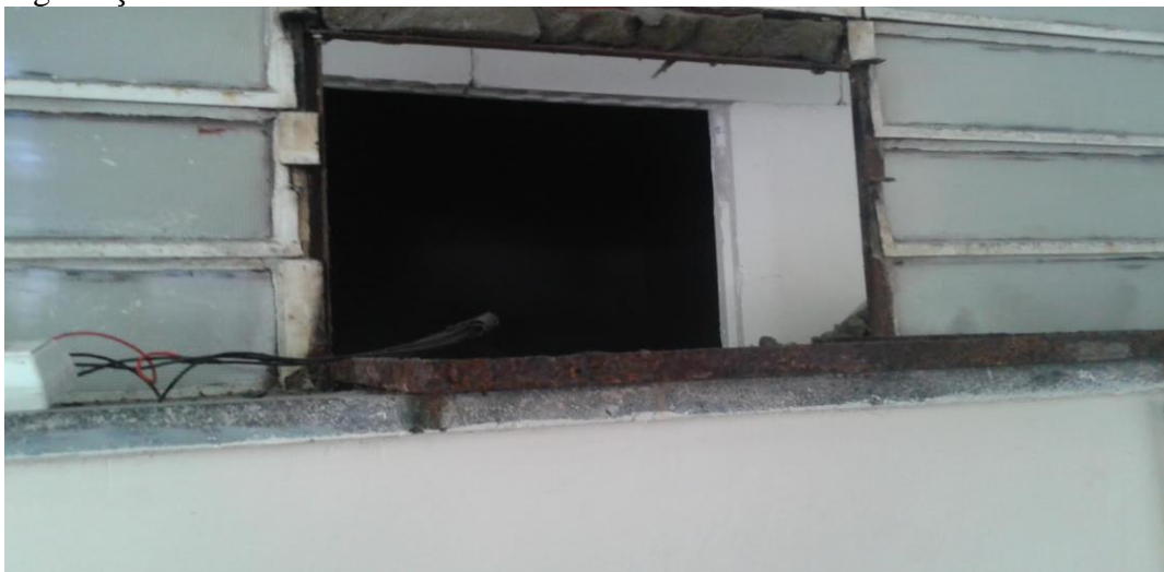
Foto 10: Condições elétricas da fiação do Espaço Cultural apresentam riscos à segurança.
