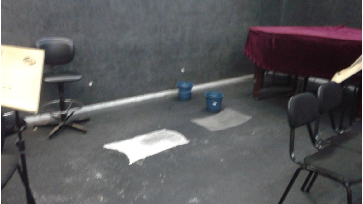
Foto 1: Baldes utilizados em sala de aula para conter vazamento do aparelho de ar-condicionado.
