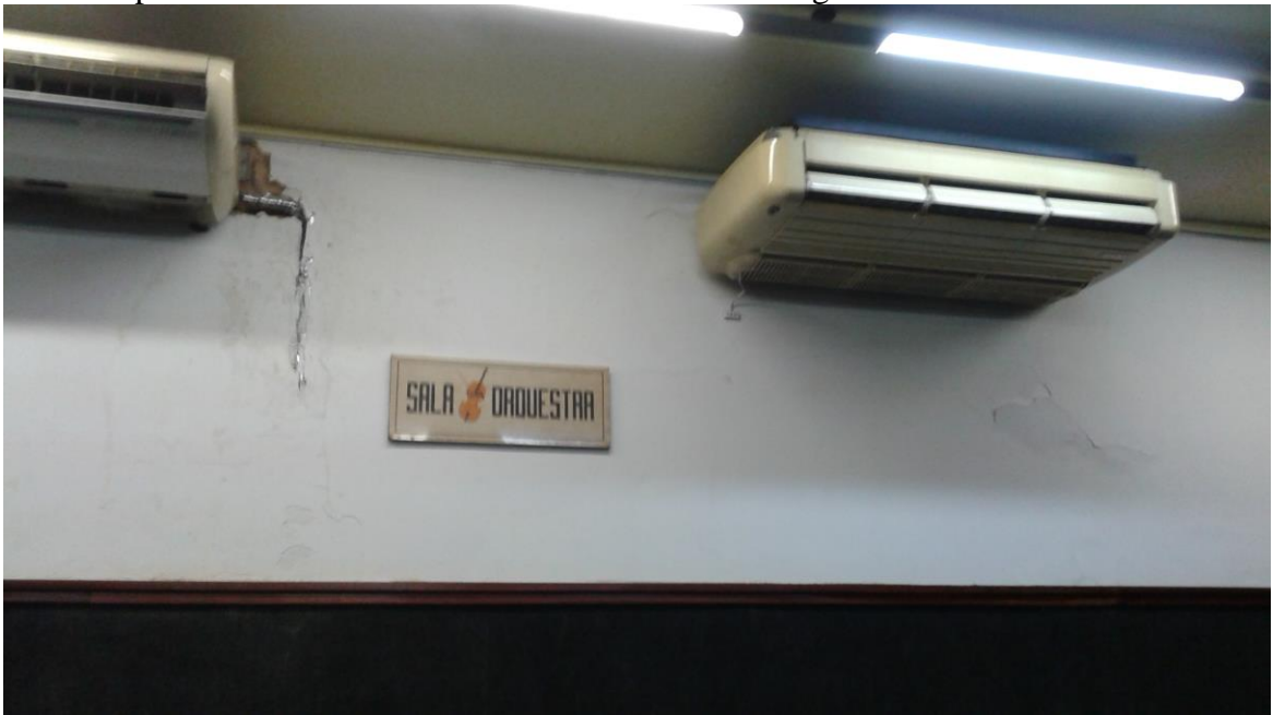
Foto 2: Aparelho de ar-condicionado com vazamento de água em sala de aula.
