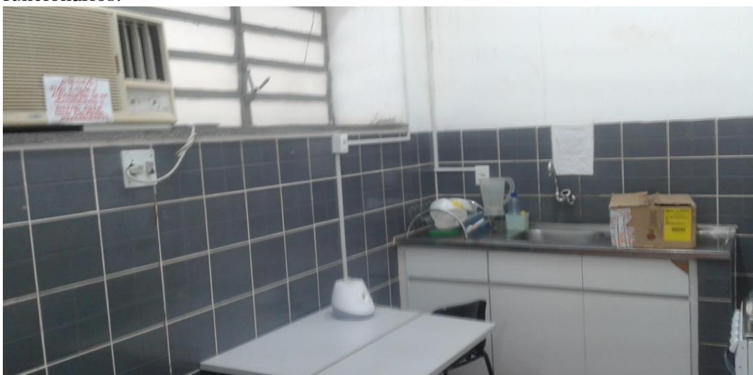
Foto 4: Aparelho de ar-condicionado quebrado da sala usada como “copa” para os funcionários.
