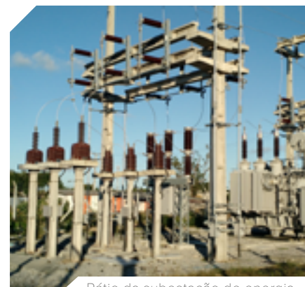
Pátio da subestação de energia
