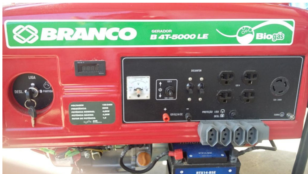
Figura 20: Gerador Utilizado para Conversão
