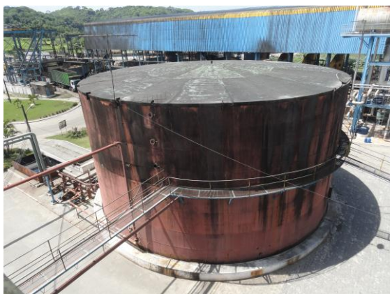
Figura 4.2 – Tanque de mel.
